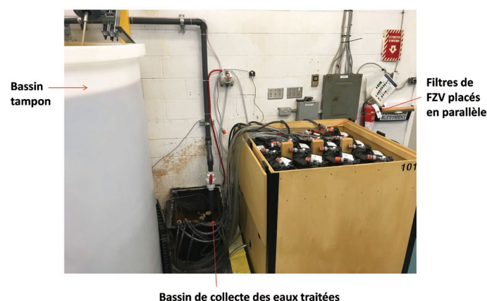
FIGURE 2 Filtres de FZV et réservoirs de collecte des eaux traitées
